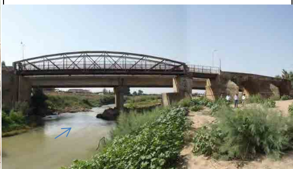
10.Situation des colonnes de l'ancien pont de Jedeida (Août 2012)
