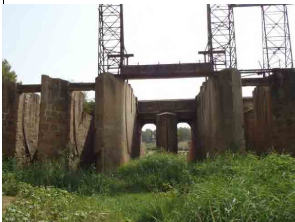
07.Situation des colonnes du pont El Battan (Août 2012)
