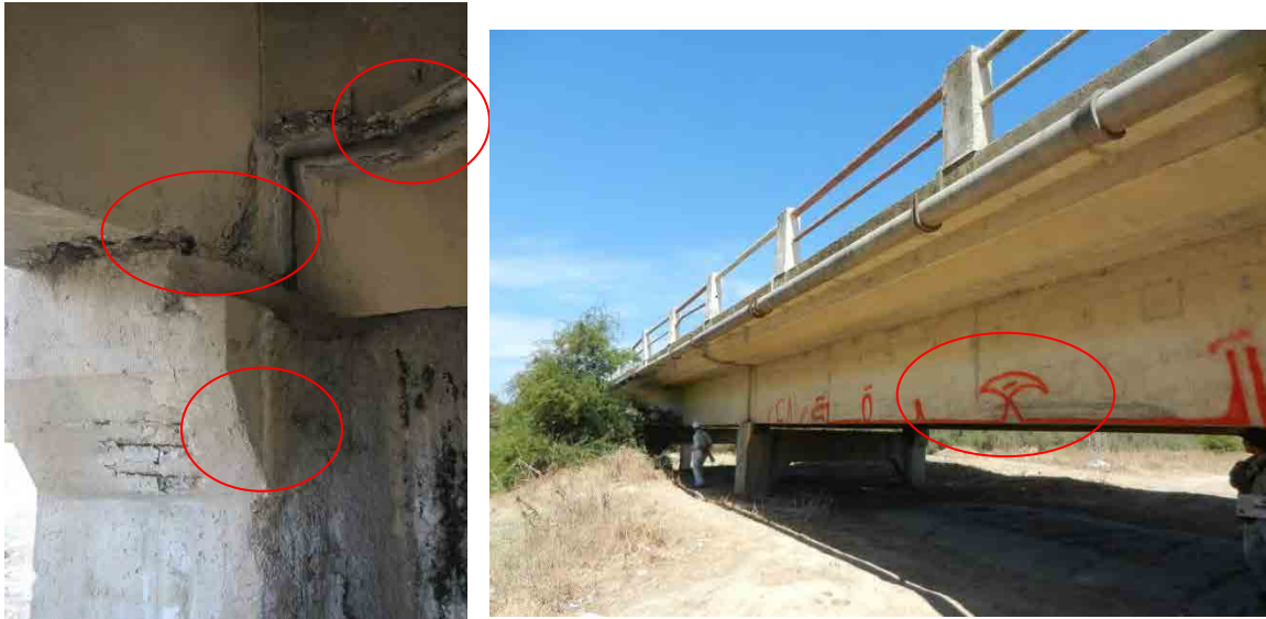
1) 橋脚、主桁の剥離・鉄筋露出
