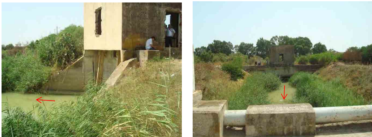
図 3- エル・マプトゥ遊水地放水路のメジェルダ川合流地点とゲート設備
