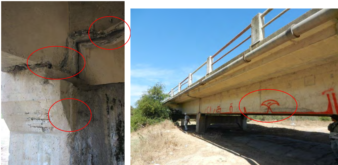
1) 橋脚、主桁の剥離・鉄筋露出
