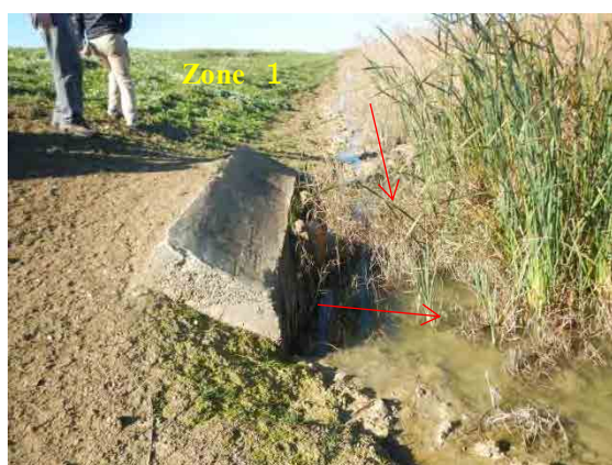
図 3-27 排水樋管出口のフラップゲート
