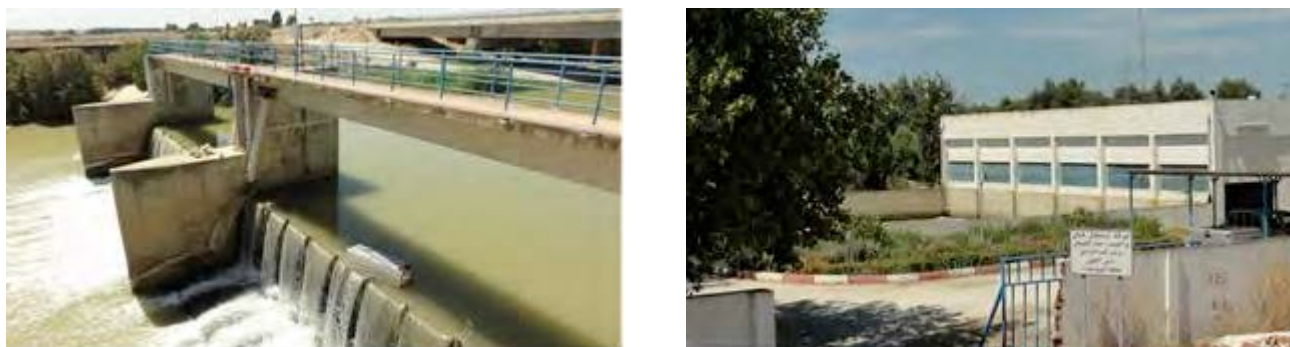
図 2- 左：転倒ゲート2門(手前側)と固定堰状況／右：直上流左岸側の取水施設のポンプ機場
