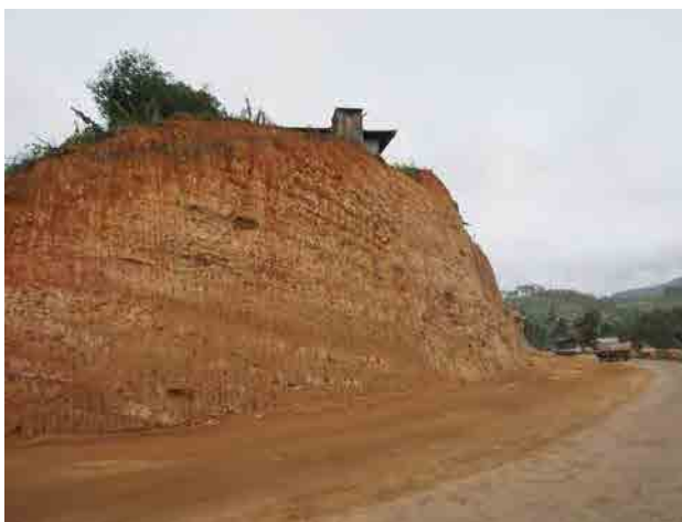
図 2-16 典型的な切土のり面、勾配が急すぎ、排水施設がない
