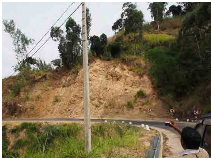
図4-4 A005-091 の斜面崩壊 (全景)
