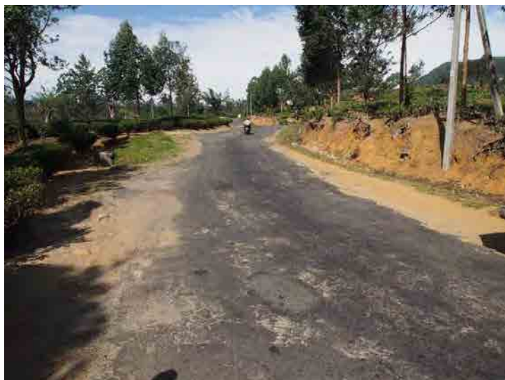
図4-9 B413-070 地すべり (B413 の舗装の沈下)
