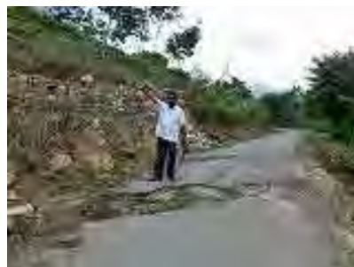
vi) 道路に入った亀裂の状況。パドゥッラにて。
