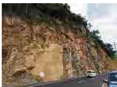
iv) 岩盤崩壊が危惧される急崖。国道A026号線にて。
