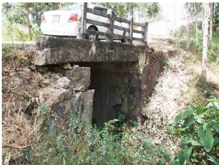
図4-10 B413-070 地すべり (Km70 地点の小さな橋の橋台に入ったクラック)
