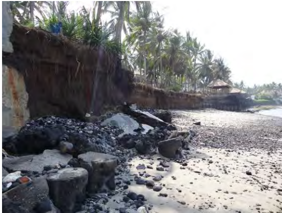
写真 11.3.1 海岸侵食および土地侵食
