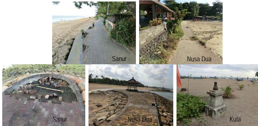
写真 2.2.3 公共施設の損傷
