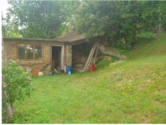
地盤の変動により歪んでしまった家 (コスタンジェック地すべり地)
