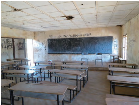
写真 9：老朽化した既存教室内部 コウモリ被害や雨漏りが確認されている。(Ⅲ-1 第8中学校)
