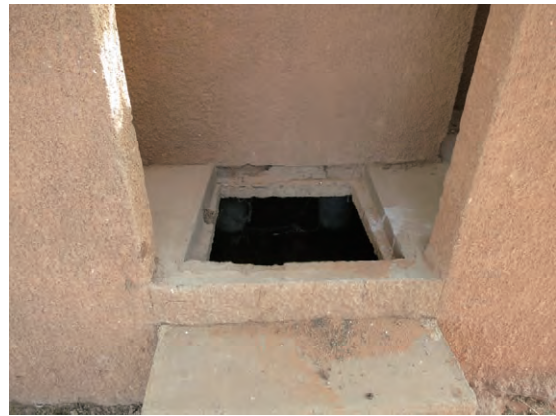
写真 16：トイレ棟のピット点検口 トイレ入口にあるピット点検口の蓋が壊れたため、立ち入り禁止となっている。(Ⅲ-1 第 8 中学校)
