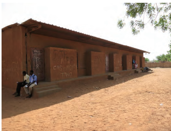
写真 7：老朽化した既存教室棟 1980年代に建てられた庇の大きな既存教室棟。 壁にクラックが見られる。(Ⅲ-1 第8中学校)
