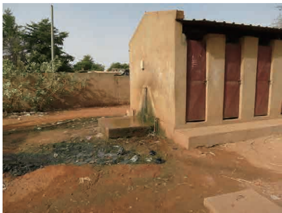
写真 11：既存トイレ トイレの外壁には水道が設置されている。 (I-1 フランス・アミエ・ニジェル中学校)
