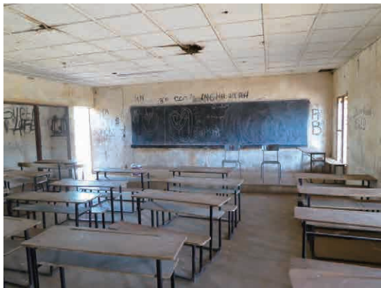
写真 9：老朽化した既存教室内部 コウモリ被害や雨漏りが確認されている。(Ⅲ-1 第8中学校)
