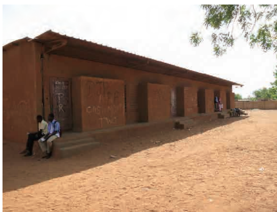
写真 7：老朽化した既存教室棟 1980年代に建てられた庇の大きな既存教室棟。 壁にクラックが見られる。(Ⅲ-1 第8中学校)
