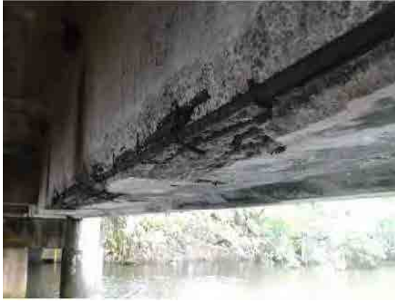
コンクリート桁の鉄筋露出・腐食 Kalutara(AA002-31/3)
