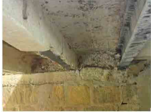
H鋼巻立てコンクリートの剥落 Kalutara(B224-11/5)
