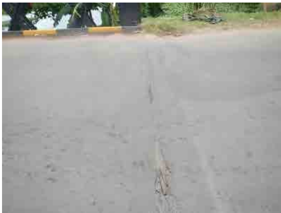
伸縮装置の損傷 Colombo(B388-2/5)
