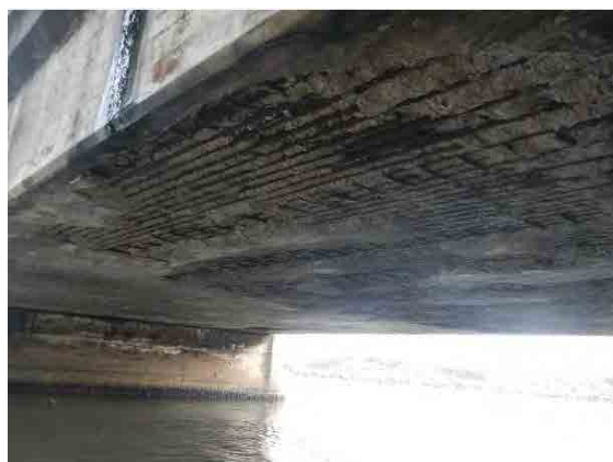
[塩害によるコンクリート剥離 / 鉄筋の露出・腐食]
