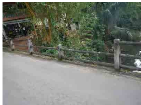
高欄の損傷 Matara(B607-10/1)
