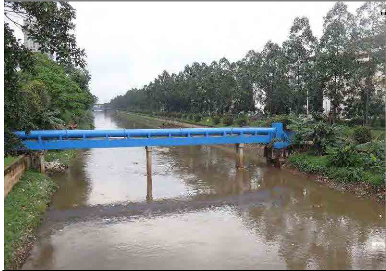
河川 (Banjir Kanal) を横断する水道水管橋梁、Banjir Kanal は洪水調整機能を担う河川
