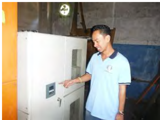
研修で得た知識を活用し導入した省エネのための機材により工場の 10%の省エネにつなげた (MIRDC)
