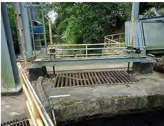
写真 1-1 土砂吐きゲート開閉装置
