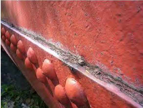
写真 5-5 リベット継手部の腐食
