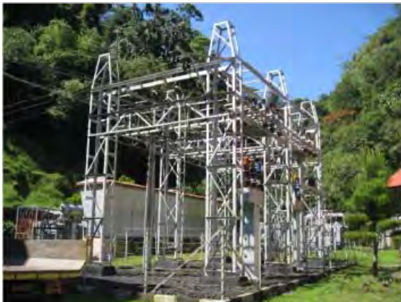
写真-29 20kV 屋外開閉所
