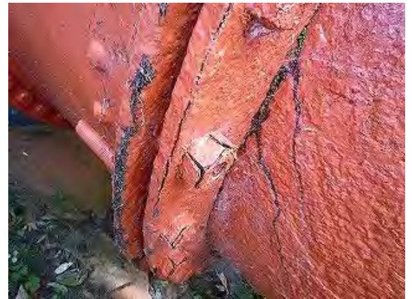
写真 5-8 ボルトの腐食状況
