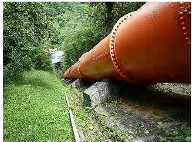
写真-12 1号水圧鉄管全景 (サージタンク側より下流方向をみる)
