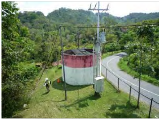
写真-9 サージタンク (水車3台に共用) 水圧鉄管はこの左手になる
