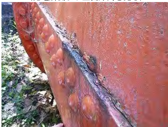
写真 5-3 リベット継手部の腐食と漏水跡
