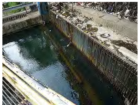
写真 2-2 取水口スクリーン
