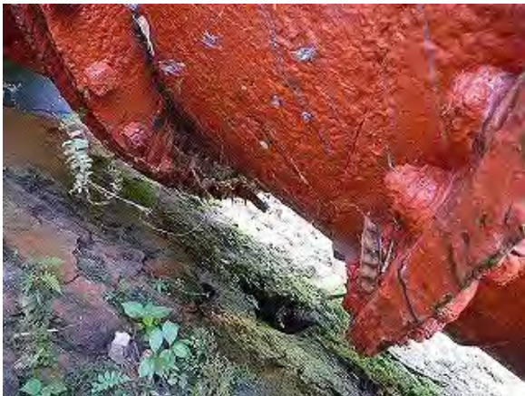
写真 5-7 伸縮継手部の腐食と漏水跡
