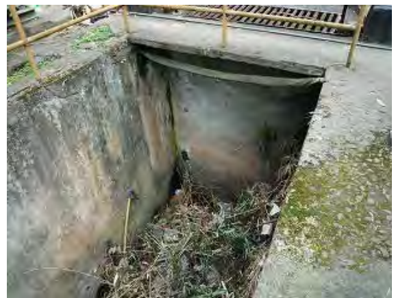
写真 1-2 土砂吐きゲート下流側の塵芥
