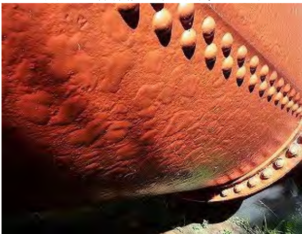
写真 5-9 表面の腐食状況
