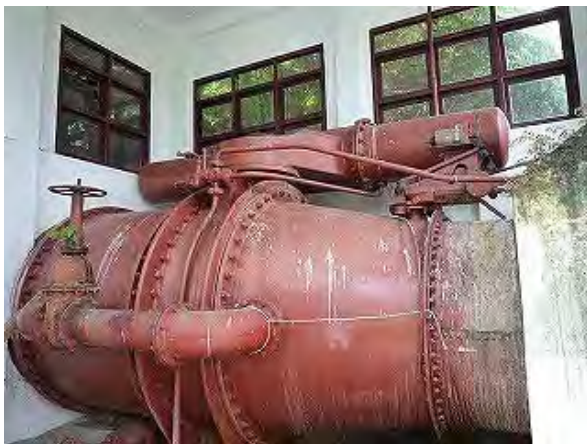
写真-11 1号鉄管弁全景 (バルブハウス内)
