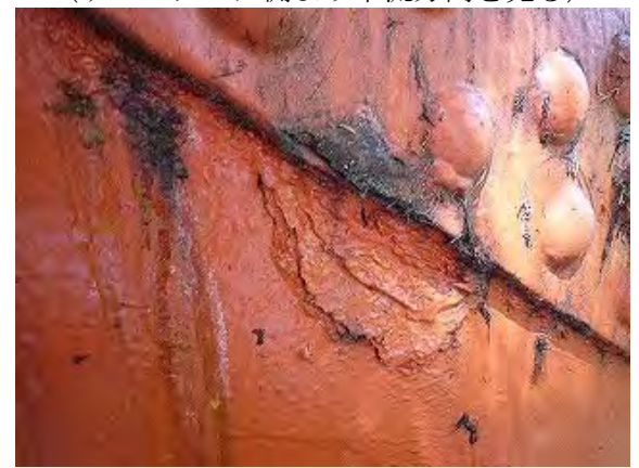
写真 5-4 リベット継手部の腐食と漏水跡
