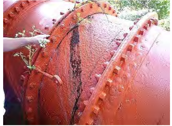
写真 5-6 伸縮継手部の腐食と漏水跡
