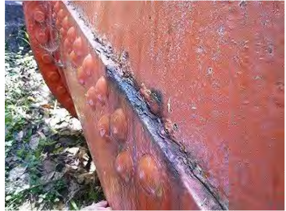
写真-14 1号機水圧鉄管 リベット継手部の腐食と漏水跡
