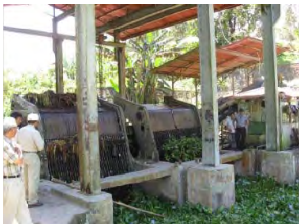
写真-3 導水路中間地点の除塵機
