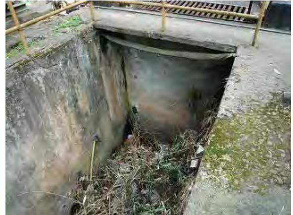
写真-8 故障中の土砂吐きゲートの下流側 塵芥がたまっている
