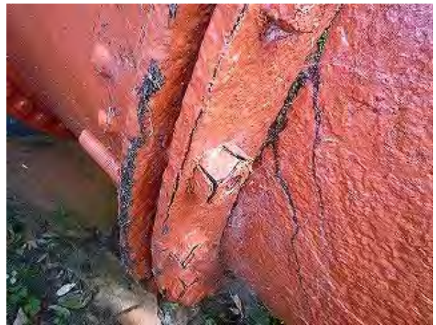
写真-16 1号水圧鉄管 ボルトの腐食状況
