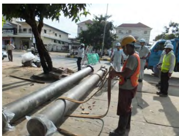
R4 (DIP 管 φ300) : T 型管は日本では製作していないため施工者関連会社のインド工場で作られたもの。異型管は日本から調達している。
