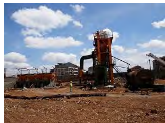
写真 - 19 アスファルト表層プラント（現場から約20km）
