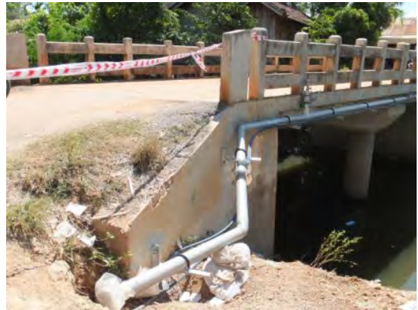
橋梁添架<プルサット>：SUS304 露出管。空気弁や管サポートも SUS 製であり、ボルト等盗難が危惧される。
