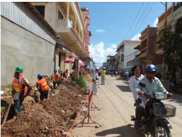
R1 (HDPE \phi 50) : 街中の配管。路地は狭いが交通量が多い。一区間を一日で終了させたいため作業員を増員して手堀りで掘削、管付設、埋戻し、締固めの施工を行っている。
