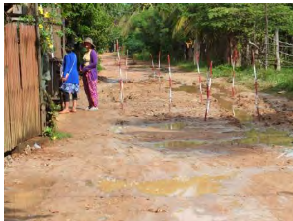
E2 (HDPE φ150) : 配管敷設と埋戻しは終了しているが、埋設箇所でない場所が浸水したまま、水たまりができている。
