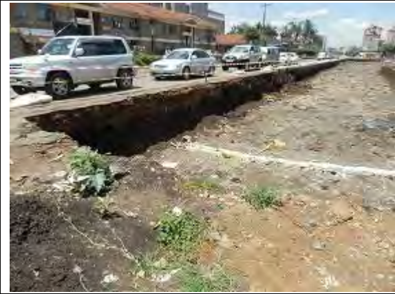
写真 - 7 既存道路下の不良土(車道下の黒く見えている部分)
