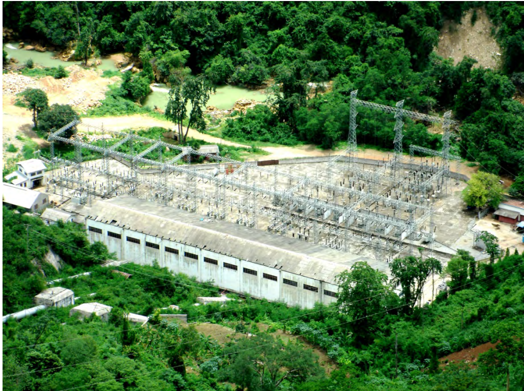
バルーチャン第二水力発電所全景
