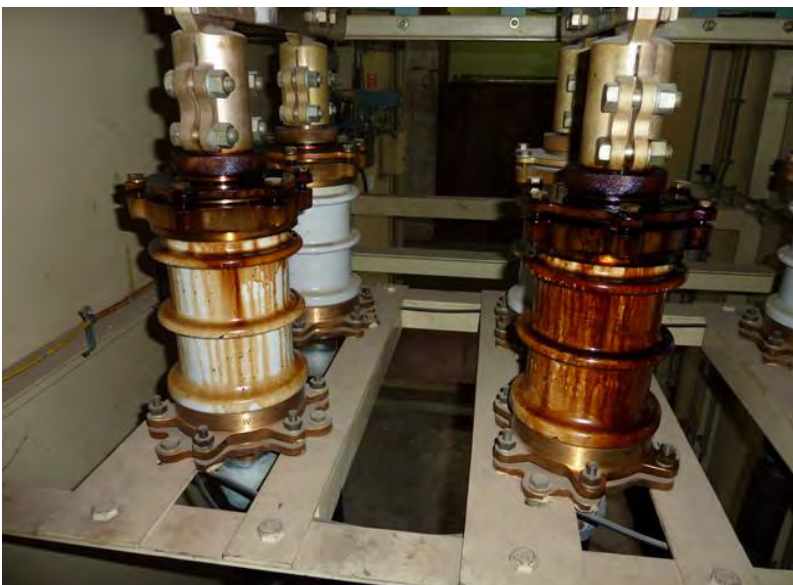
発電機～主要変圧器間の諸装置 (発電機用キュービクル(1-3号機))
