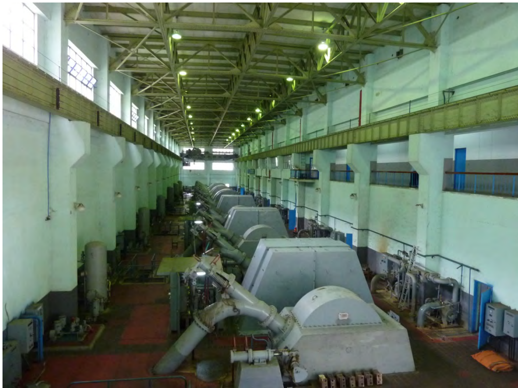
発電所建屋内（手前から6号水車発電機）
