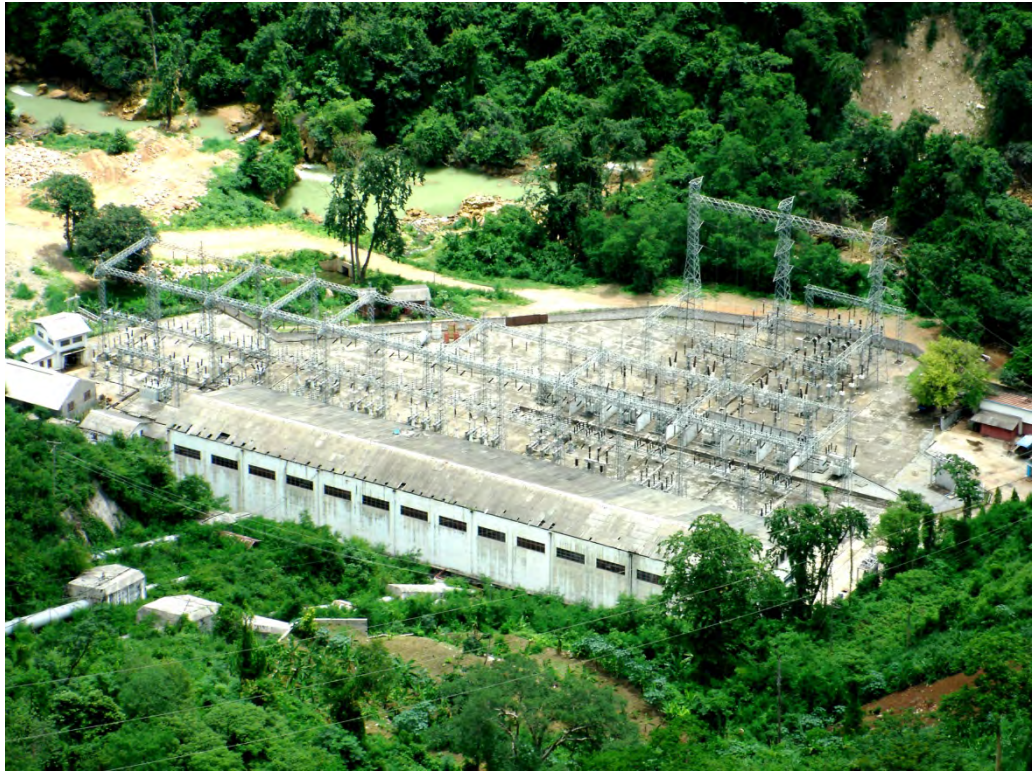
バルーチャン第二水力発電所全景
