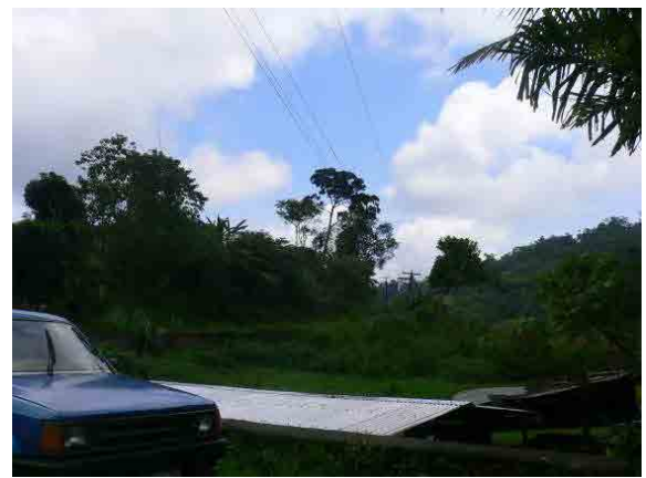
写真-8 : 既設13.2kV配電線。新発電所が連系される既設配電線は、現状木製ポールが多用され、その状態が悪いため、安定供給の観点からスチール製への改修を行う。さらに、新発電所まで3相配線とする。
