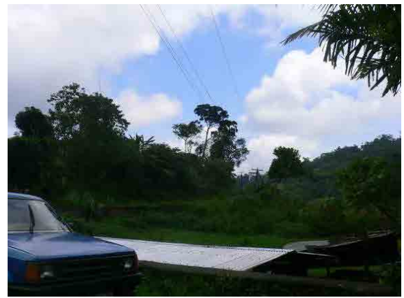
写真－８：既設13.2kV配電線。新発電所が連系される既設配電線は、現状木製ポールが多用され、その状態が悪いため、安定供給の観点からスチール製への改修を行う。さらに、新発電所まで3相配線とする。
