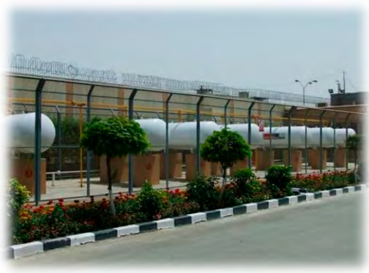
ガス不足に備えての産業用ガスタンク
