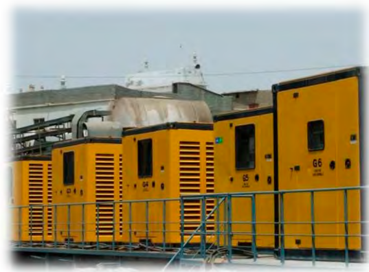
電力不足に備えての産業用自家発電装置
