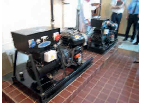
我が国の支援で整備されたコールドチェーン用発電機
