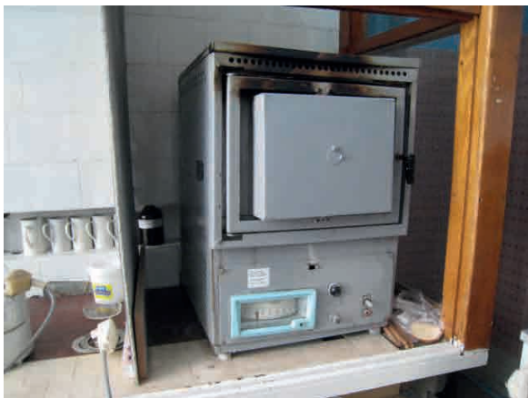
経年変化で老朽化したマッフル炉
