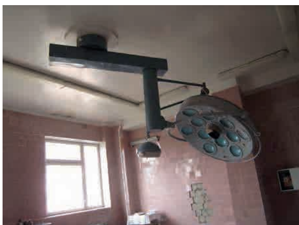
別の手術室。壁のタイルが剥がれている。同じく現在使用されておらず改修待ち。无影灯は旧ソ連邦時代から20年以上使用していた。
