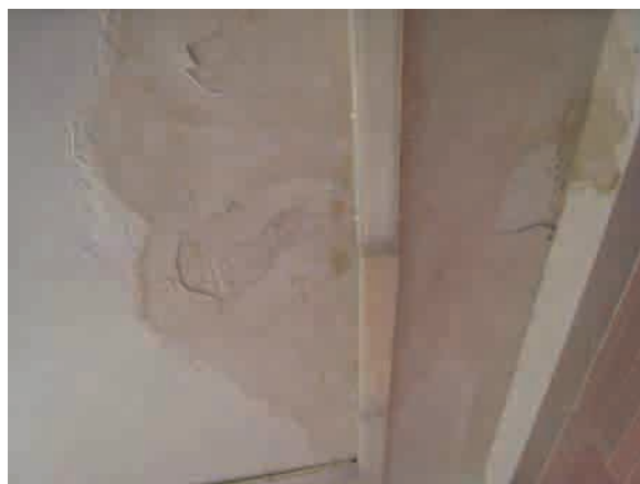
手術室の雨漏りのしみ、このため本手術室は現在使用されておらず改修待ち。
