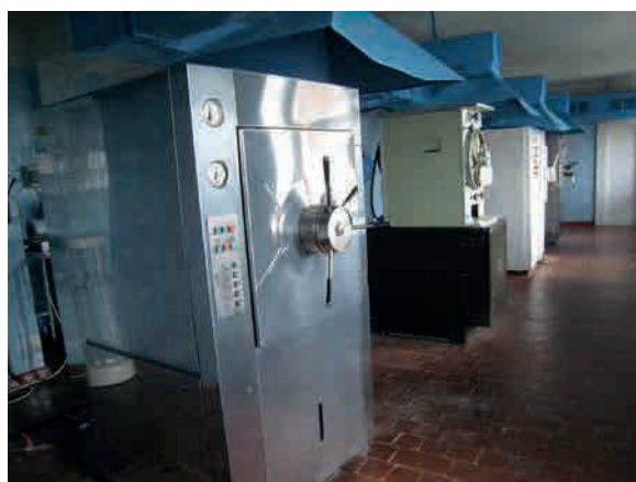
手術部に隣接している中央滅菌室。機材はすべて片扉タイプでメンテ側とオペレータ側が仕切られていない。
