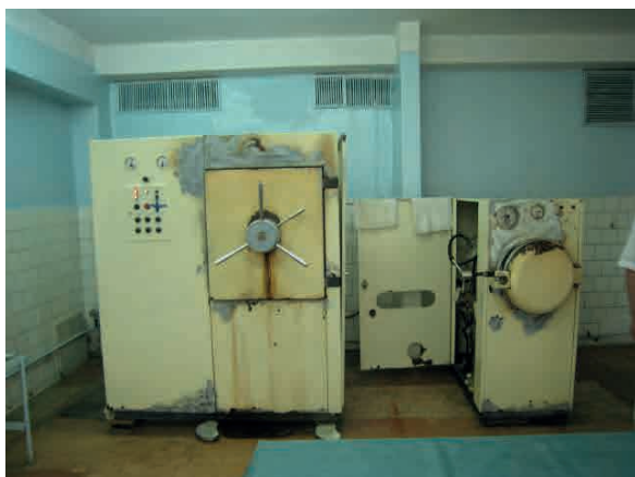
中央滅菌室の高圧蒸気滅菌器
