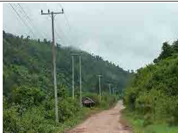
写真-6：既設 22kV 配電線の状況。本プロジェクトは、この配電線に接続される。2012 年 3 月から供用開始されたばかり。
