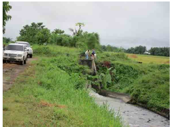
(5) 収穫期は水位を下げるため、土手が露出し所々に崩壊が見られる。敷のコンクリートに破損はなく健全である。
