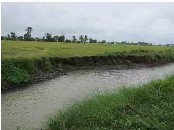
(4) 低水位期の水路の状態(2012/10/04) 田地の一部が浸食され、耕作土である粘性土が露出する。
