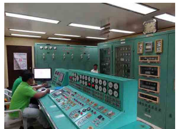
写真-6：マガット川灌漑事務所が運営するバリガタン水力発電所。発電所運転員のプラントスーパーバイザーや複数のオペレーターは相当の運転経験を擁している。
