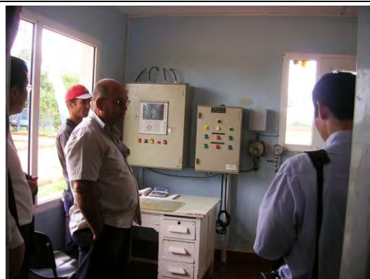
ハバナ市に給水する HS-3 トラムの 井戸群の操作室及び操作盤
