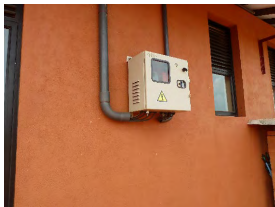
写真 2d : 電気メーター
