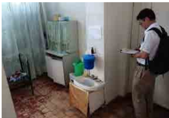
ジョミ郡中央病院（産科棟）手洗器 現在給水できず青いタンクに水を補給し使用している。
