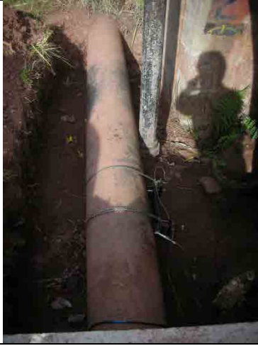
超音波流量計の設置状況 (リンデロ配水池 ピカチヨ地点)
