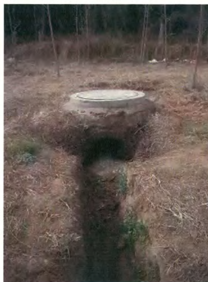
汚水管渠への違法接続
