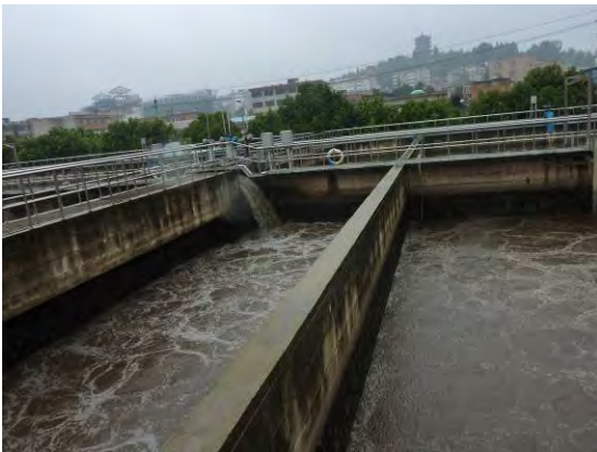
昆明市呈貢处理場(SBR) 回分槽 (流入工程)
