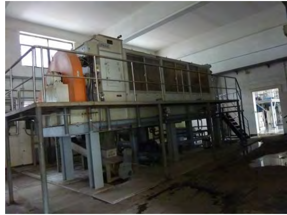
北京市高碑店処理場 汚泥処理施設 (脱水機)
