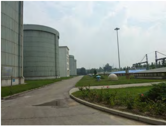
北京市高碑店処理場 汚泥処理施設 (左側が消化槽、右側が濃縮槽)
