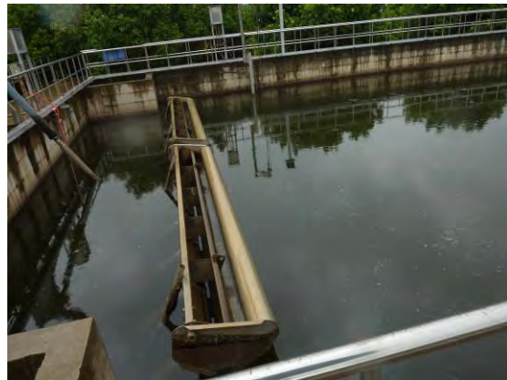
昆明市呈貢处理場(SBR) 回分槽 (排水工程)
