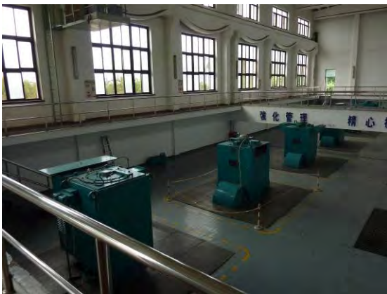
北京市高碑店処理場 ポンプ施設
