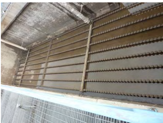
北京市高碑店処理場 反応槽 全面曝気ディフューザー
