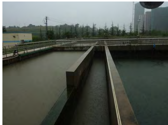
雲南省石林处理場(SBR) 回分槽
