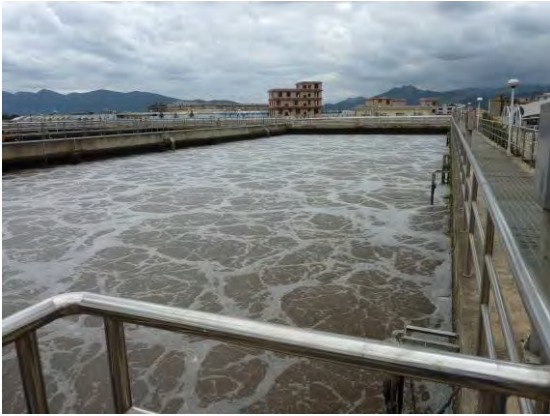
昆明市第3处理場(SBR) 回分槽 (曝気工程)
