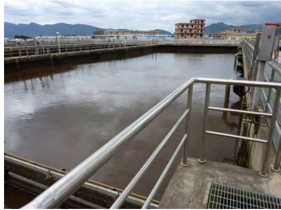
昆明市第3处理場(SBR) 回分槽 (沈殿工程)
