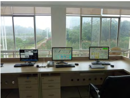
雲南省石林处理場(SBR) 監視室
