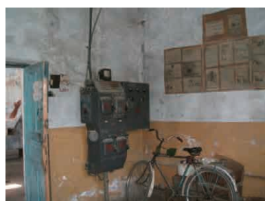
ボクタル事務所内の電気室 他に、ワークショップ機材保管 用の部屋もある
