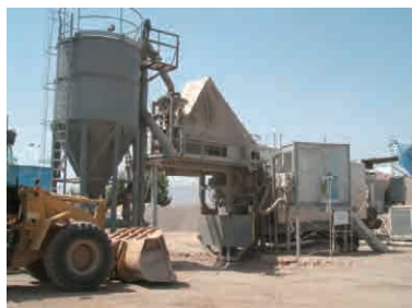
日本の工事業者所有のアスファルトプラント(ルミ事務所管内)
