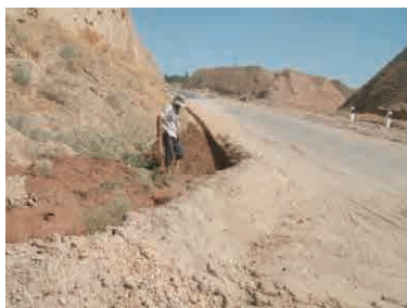
クムサンギール事務所管内の崩落が続く斜面、側溝の清掃中
