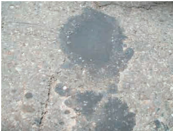
コールドアスファルトにて 修理したポットホール状況
