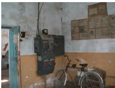
ボクタール事務所内の電気室他に、ワークショップ機材保管用の部屋もある
