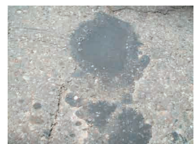
同左、ポットホールの補修はコールドアスファルトを埋めただけ
