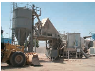
日本の工事業業者所有のアスファルトプラント(ルミ事務所管内)
