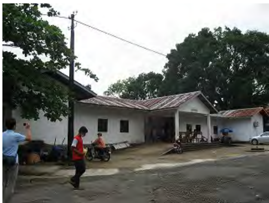
西側外観。屋根は折板。錆が目立つ。
