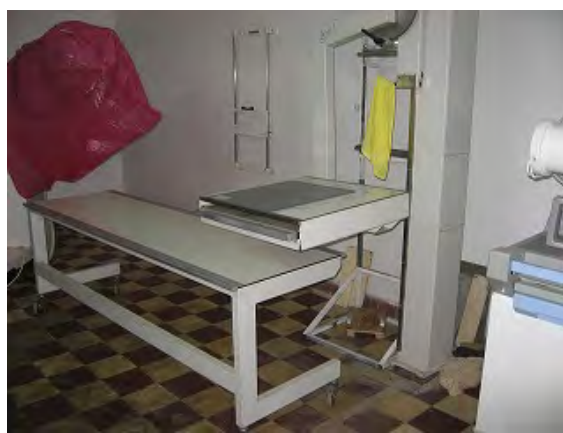
X線撮影室。固定式は故障中。
