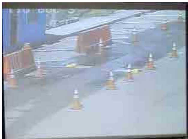
図 2-2-9 可動式の重量計測装置の設置例
