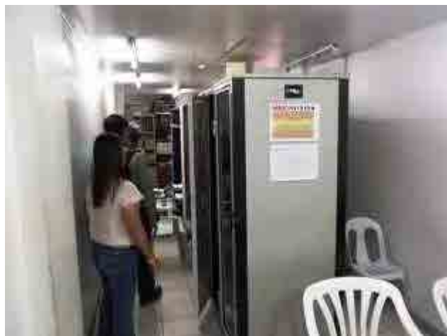
信号制御装置のラック配置状況
