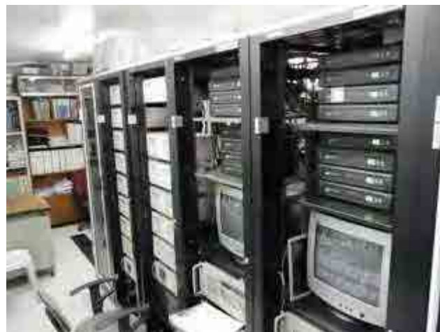
信号制御装置のラック実装状況
