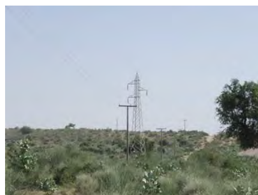
写真 5.1-2 既存 66kV 送電線
