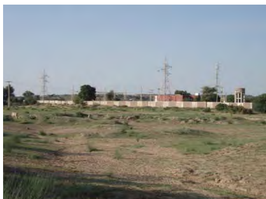
写真 5.1-1 66kV イスラマコット変電所
