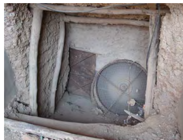
写真 2.3-6 坑内採掘通気の為のファン
