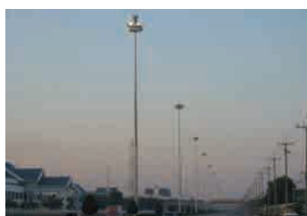
観光地における照明設備
