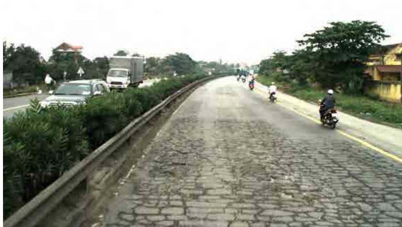
図 44 ひび割れ率 70%の例 (NH.5 上り 84k000-84k100)
