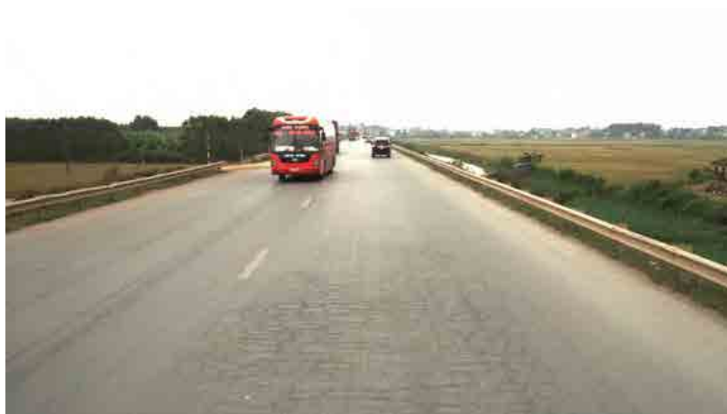
図 43 ひび割れ率 30%の例 (NH.18 上り 17k200-17k300)
