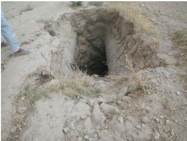
ヌルバクシュ用水路 地盤陥没
