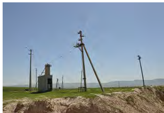
ヌルバクシュサイト近傍の変圧器(10kV/400V)
