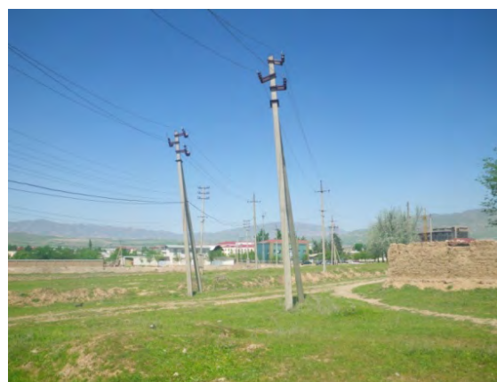
変電所近傍の 220 V 配電線
