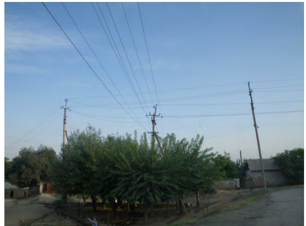
オクス村の配電設備 給電予定地であるオクス村の配電網であり、Promisel 変 電所より送電(10kV)されている。
