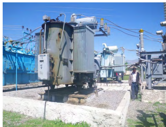
変圧器(ソビエト製)
