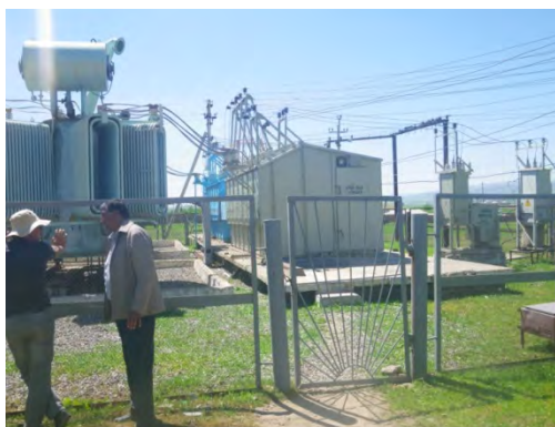
プロムセル変電所(35kV/10kV)
