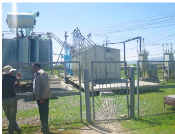
プロムセル変電所(35kV/10kV)
