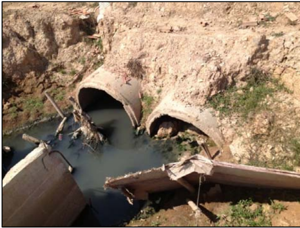
写真 7.2 : Manhattan SEZ 雨水と下水管が別々に分かれて放流されている状況
