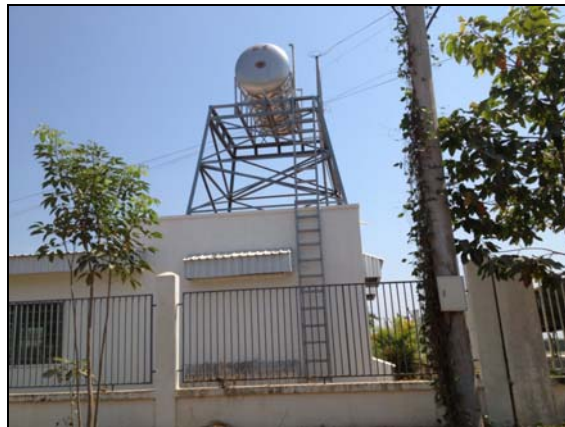
写真 7.10 : Manhattan SEZ 各工場が、工場前の地下水道管からの取水、貯留状況
