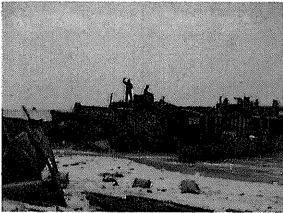
Démolition et mise au rebut de carcasses de vieux rafiots au point D
