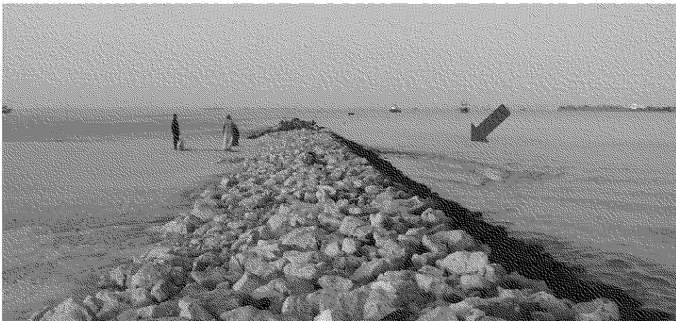
図-2.2.4(27) 突堤上を越流した砂の堆積（2012年7月22日干潮時撮影）
