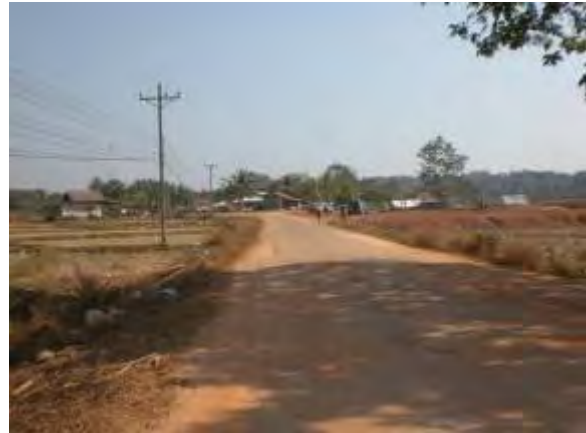
県内のProvincial Road DBST舗装または砂利道路。路面の劣化が目立つ
