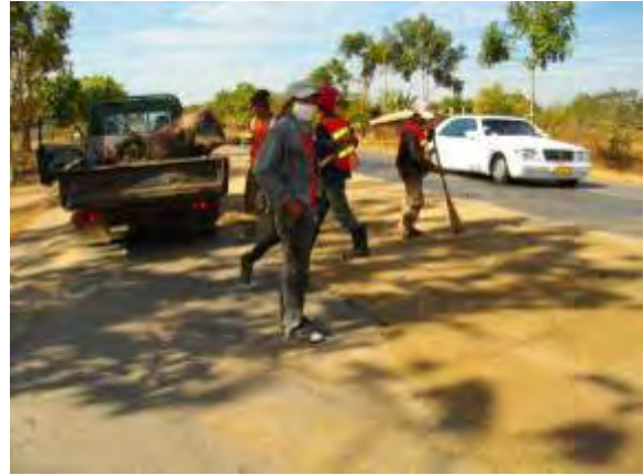
9号線の業者(クンサイ)による補修工事、雨季前に悪い区間をスポットでDBSTで補修。
