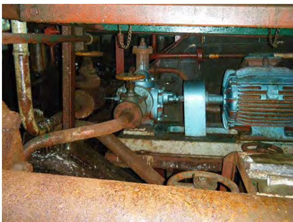
(CAI 号) 機関室床下のポンプ類
