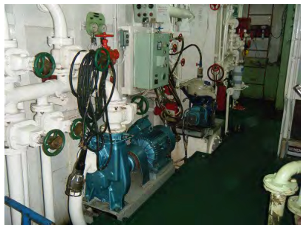
(CAI 号) 機関室補機類
