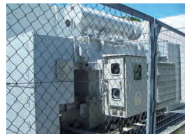
主変圧器（ラナディ変電所）
