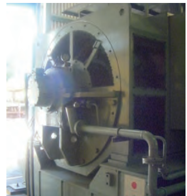
新設されたディーゼル発電機 （ルンガ発電所）
