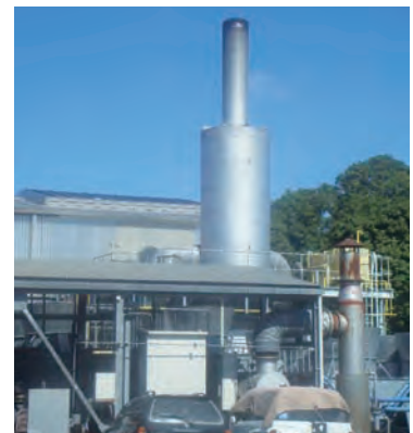
排気塔（ルンガ発電所）
