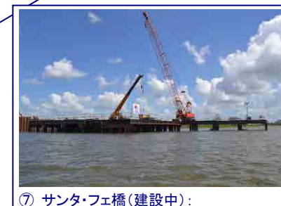
⑦ サンタ・フェ橋(建設中): コスタリカ国境に近いサン・ファン川に架る橋梁である。現在、日本の無償資金協力により建設中である。
