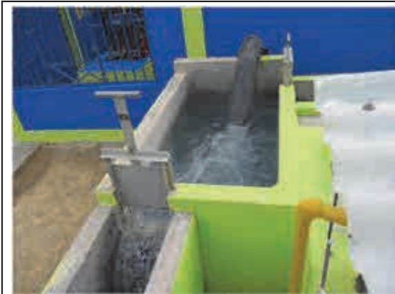
取水施設。井戸出口にタンクを建設し、その右側に地上タンクへの取水口が設置されている
