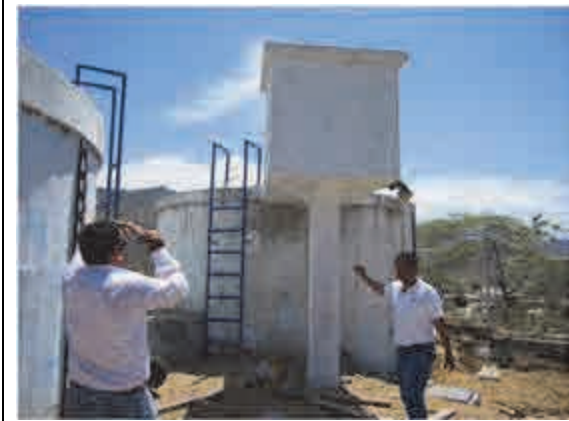
新規に建設された塩素注入施設
