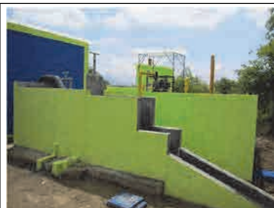
取水施設(手前)、地上タンク(奥)
