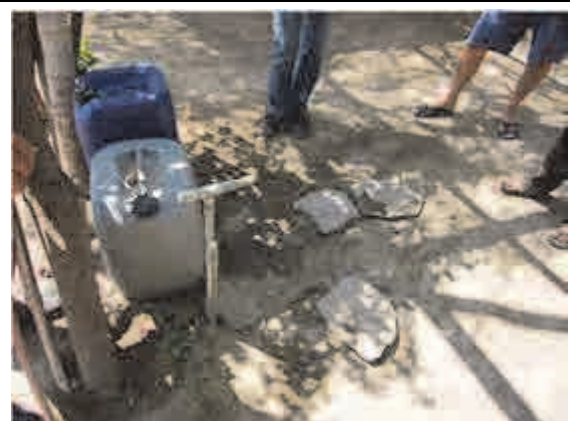
(Cojal) 家の外にある給水栓。蛇口は設置されておらず、水があるときは出っ放しである。
