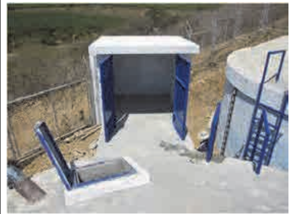
塩素注入施設
