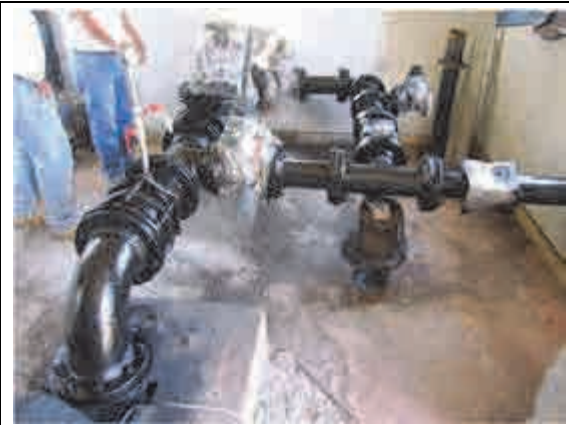
深井戸と新規配管
