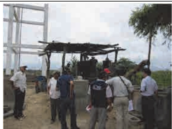
(ウメダデス) 高架タンクは建設されたが、水源井戸とはつながっていない。水源:地下水
