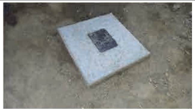
水道メーターボックス
