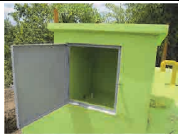
塩素注入施設。この中に塩素のタンクを設置してドリップ方式でタンクの中に塩素を注入する。
