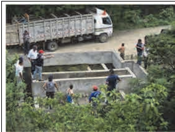
(エル・エスピナル) 緩速ろ過槽は亀裂等の発生により機能していない。水源:河川水
