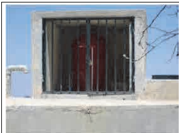
タンク上部にある塩素注入施設
