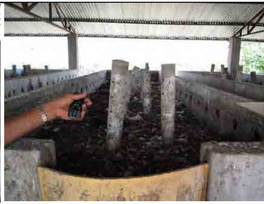
1次発酵と2次発酵は異なる発酵槽で行われ、発酵期間は前者で約15日、後者で約40日
