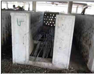
発酵槽内部（槽の底部や側壁は空気が通りやすい工夫がなされている）
