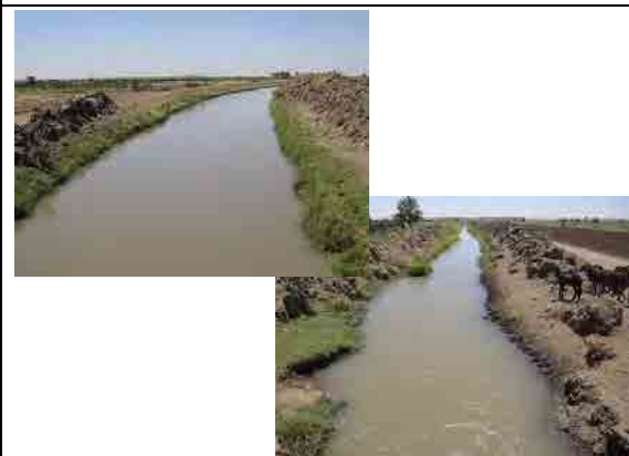
写真-6: アリアブスキーム水路の状況 (左上: 幹線水路、右下: 支線水路) 毎年大量の土砂がナイル川から運ばれ、堆積するため、水路の維持管理として浚渫が不可欠である。浚渫土は水路横に残置されている。
