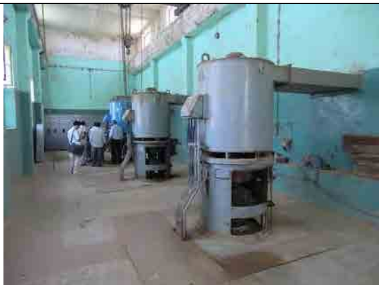
写真-5: K14 ポンプ場 建設後 37 年以上経過しており、ポンプ設備は劣化し効率も低下している。スペアパーツの入手が困難で維持管理に支障をきたしている。
