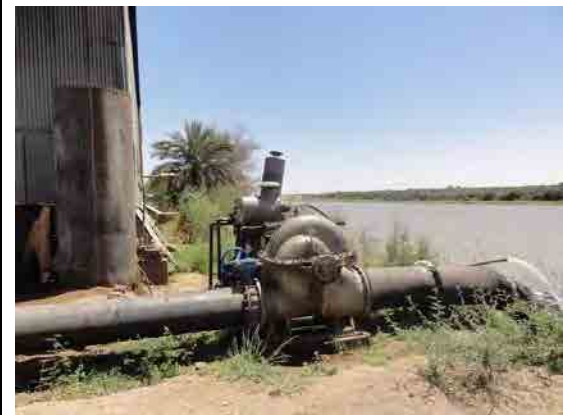
写真-4: アリアブポンプ場 地上部屋外に、2010 年(中国製)に設置されたポンプで、ナイル川の水位変動が大きく、キャビテーションを発生するため運転できない場合がある。
