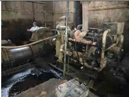
写真-1: キティアブポンプ場 建設後 65 年以上経過しており、老朽化が進み、メンテナンスにも限界がきている。
