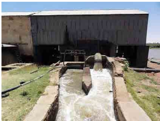
写真-3: アリアブポンプ場 建設後 39 年以上経過しており、ポンプも老朽化が進んでいる。早急なりハビリテーションが必要である。
